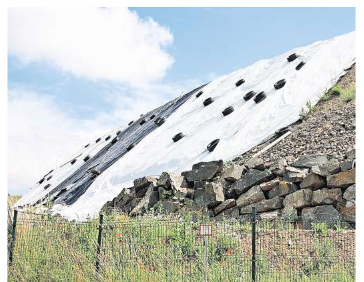
Der durch den Bau des PV-Freiflächenfeldes entstandene Hang im Interkommunalen Gewerbepark Salzbödetal muss durch eine Mauer abgestützt werden.
